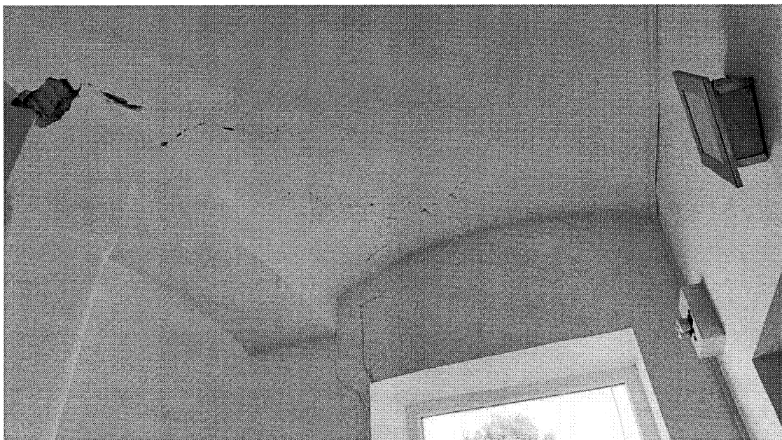
tipična oštećenja na stubištu zgrade
