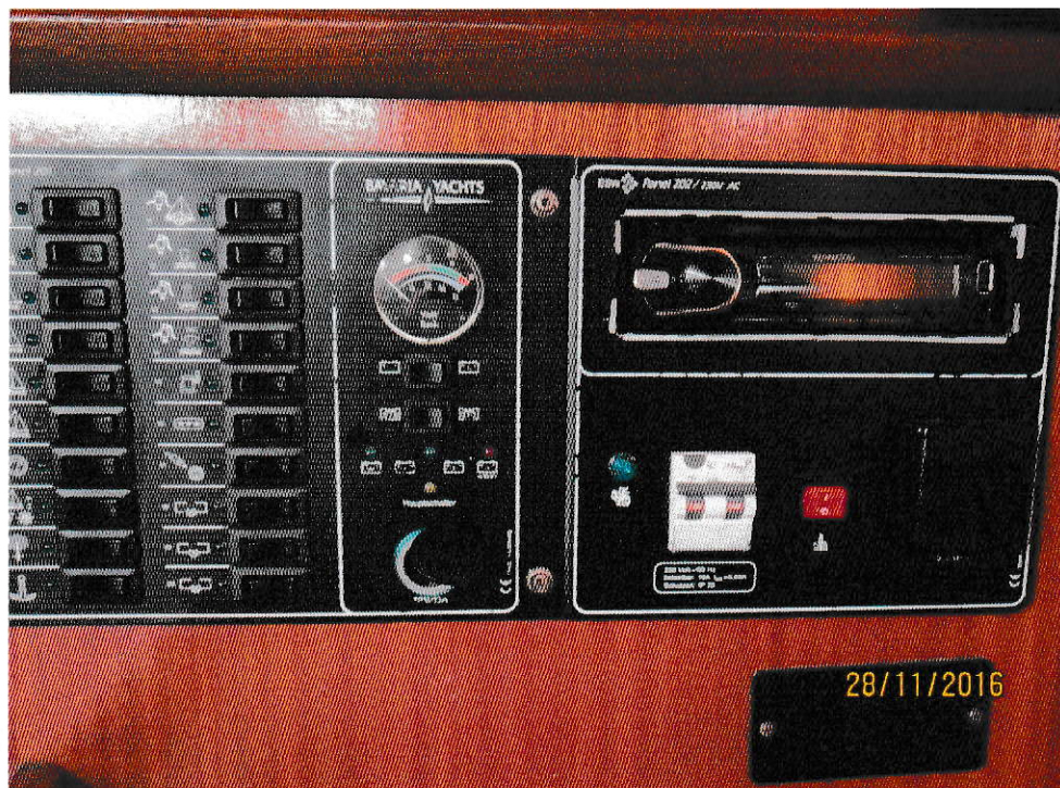
Slika 3: Razvodna ploča i radio
