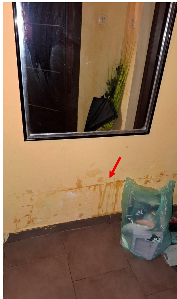
Slika 7. – zid nakon puštanja vode u tušu
