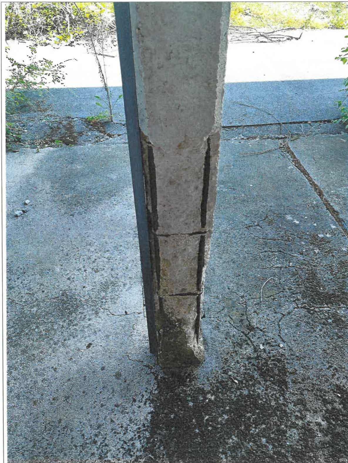
(sl. br. 9 – prikaz uznapredovale korozije armature na donjem dijelu stupa nadstrešnice sjeverne fasade; zbog korozije armature došlo je do otpadanja zaštitnog sloja betona a što je dovelo do smanjenja poprečnog presjeka stupa)
