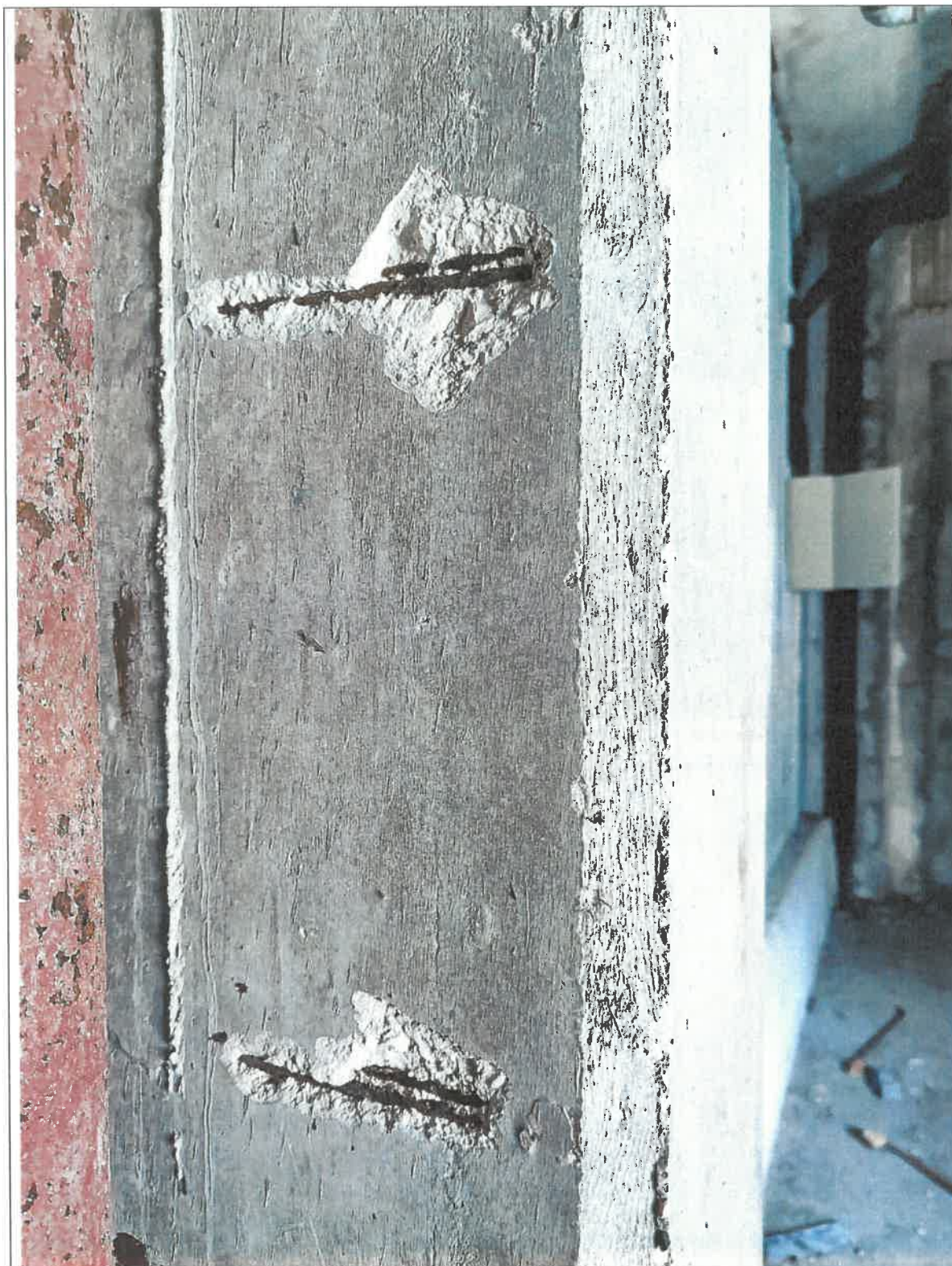
(sl. br. 23 – prikaz korozije vilica/spona na stupu „H“ centralnih stupova; manipulativni hodnik; vidljivo je da do korozije dolazi zbog nedostatne debljine zaštitnog sloja betona)
