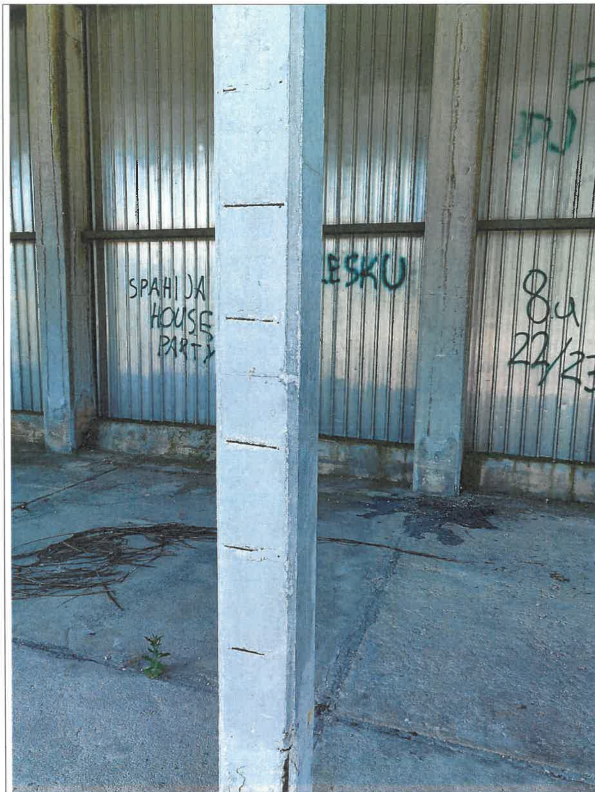
(sl. br. 12 – prikaz korozije spona/vilica AB montažnog stupa sjeverne nadstrešnice; vidljivo je da do korozije dolazi zbog nedostatne debljine zaštitnog sloja betona)
