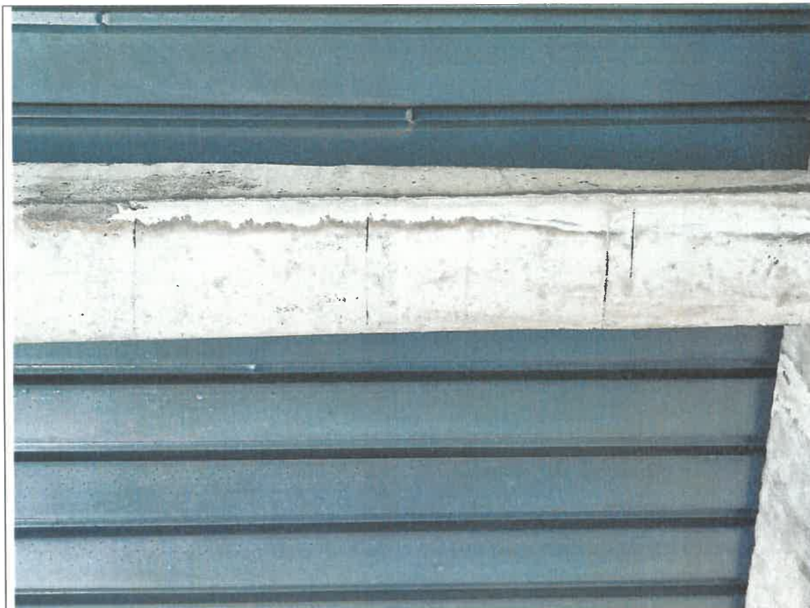
(sl. br. 15 – prikaz korozije spona/vilica AB montažne grede „V“ oblika; nadstrešnica sjeverne fasade; vidljivo je da do korozije dolazi zbog nedostatne debljine zaštitnog sloja betona)
