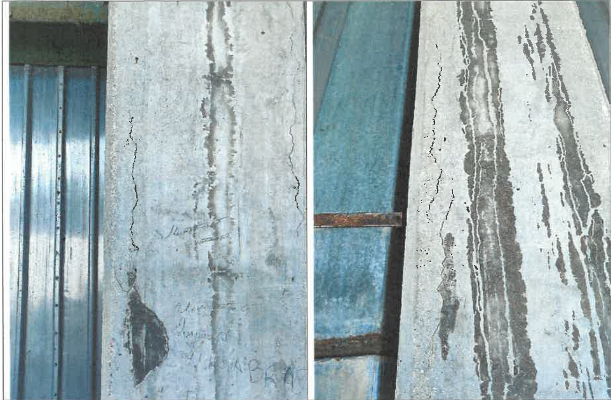
(sl. br. 16 i 17 – prikaz vertikalnih pukotina uz ugao glavnog AB montažnog stupa građevine; pukotina je prvi vidljiv znak da je došlo do korozije ugaone armature stupa)
