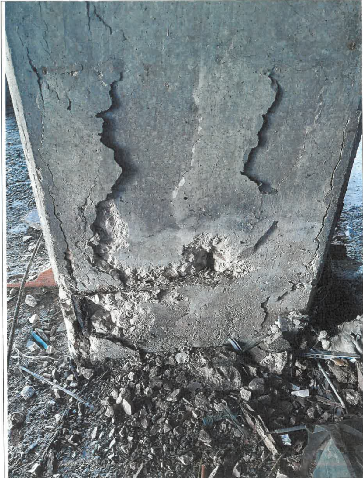
(sl. br. 18 – prikaz uznapredovale korozije armature na donjem dijelu glavnog AB montažnog stupa građevine)
