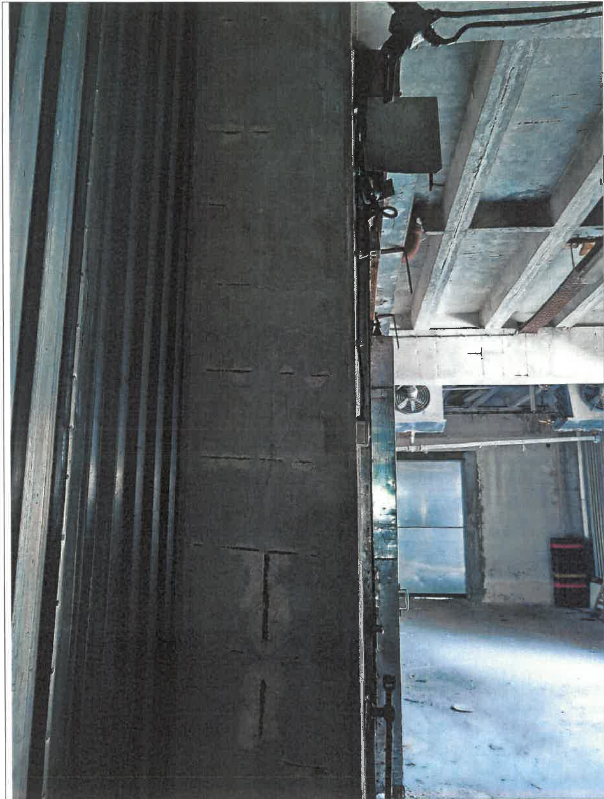
(sl. br. 21 – prikaz korozije vilica/spona na stupu „H“ centralnih stupova; manipulativni hodnik; vidljivo je da do korozije dolazi zbog nedostatne debljine zaštitnog sloja betona)
