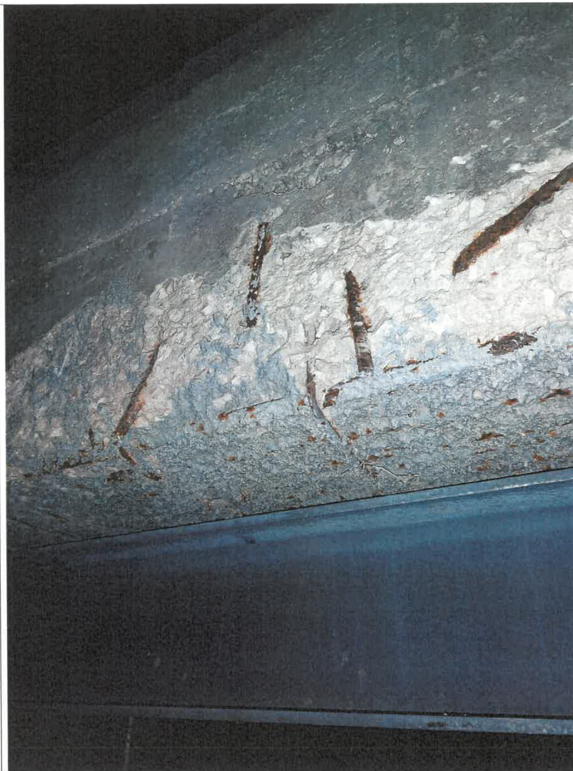
(sl. br. 35 – prikaz uznapredovale korozije armature te površinske degradacije i erozije betonske površine na AB gredi komore/tunela za smrzavanje; oštećenja su očekivana s obzirom na ekstremne uvjete koji vladaju u tunelima za smrzavanje, odnosno vrlo niske temperature u kombinaciji s velikim brzinama strujanja zraka)
