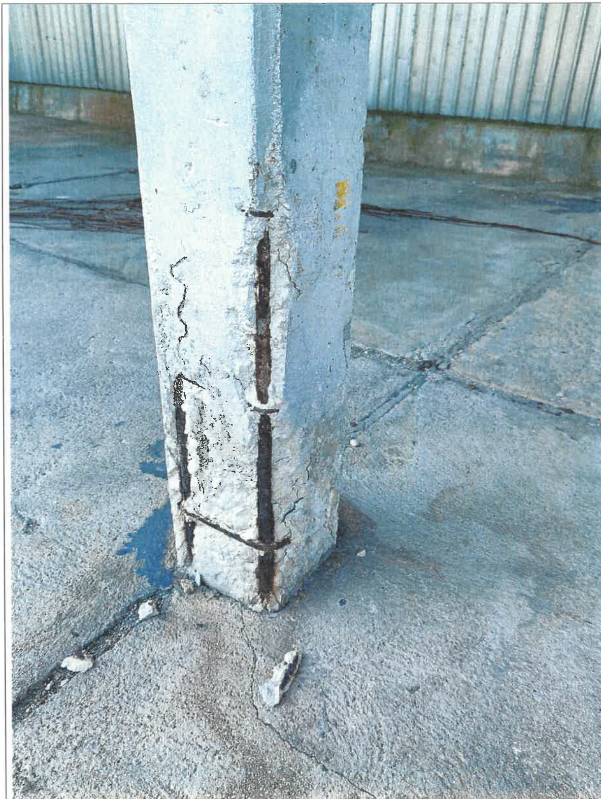
(sl. br. 13 – prikaz uznapredovale korozije armature na donjem dijelu stupa nadstrešnice sjeverne fasade; zbog korozije armature došlo je do otpadanja zaštitnog sloja betona a što je dovelo do smanjenja poprečnog presjeka stupa)
