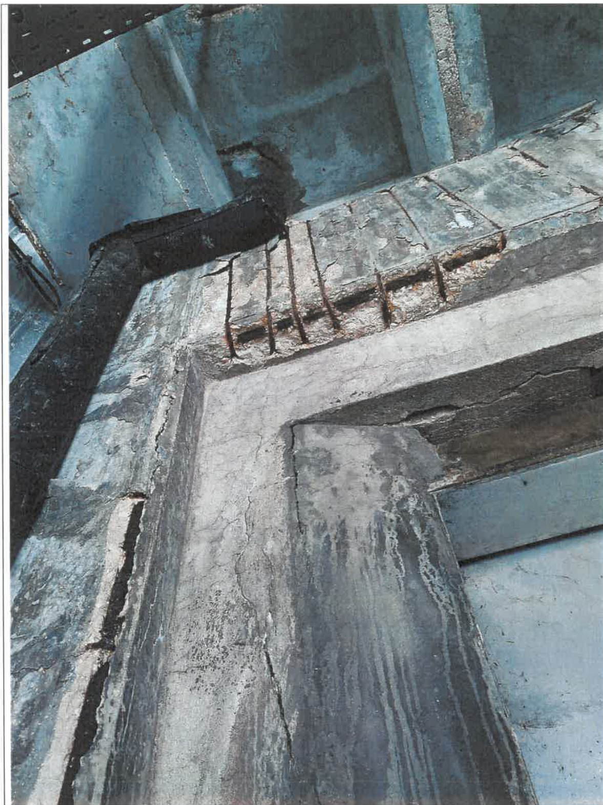
(sl. br. 25 – prikaz korozije vilica/spona na gredi i stupu „H“ centralnih stupova; manipulativni hodnik; vidljivo je da do korozije dolazi zbog nedostatne debljine zaštitnog sloja betona)
