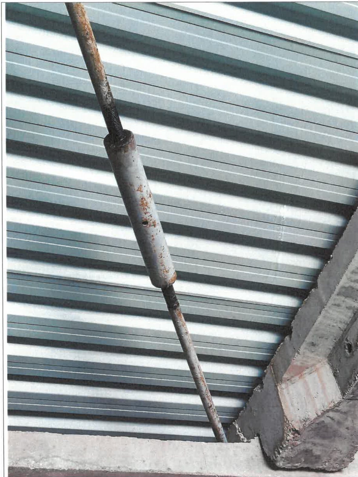
(sl. br. 37 – prikaz jedne napinjalke na čeličnoj zatezi; svaka čelična zatega horizontalnog krovnog sprega opremljena je ovakvom napinjalkom)
