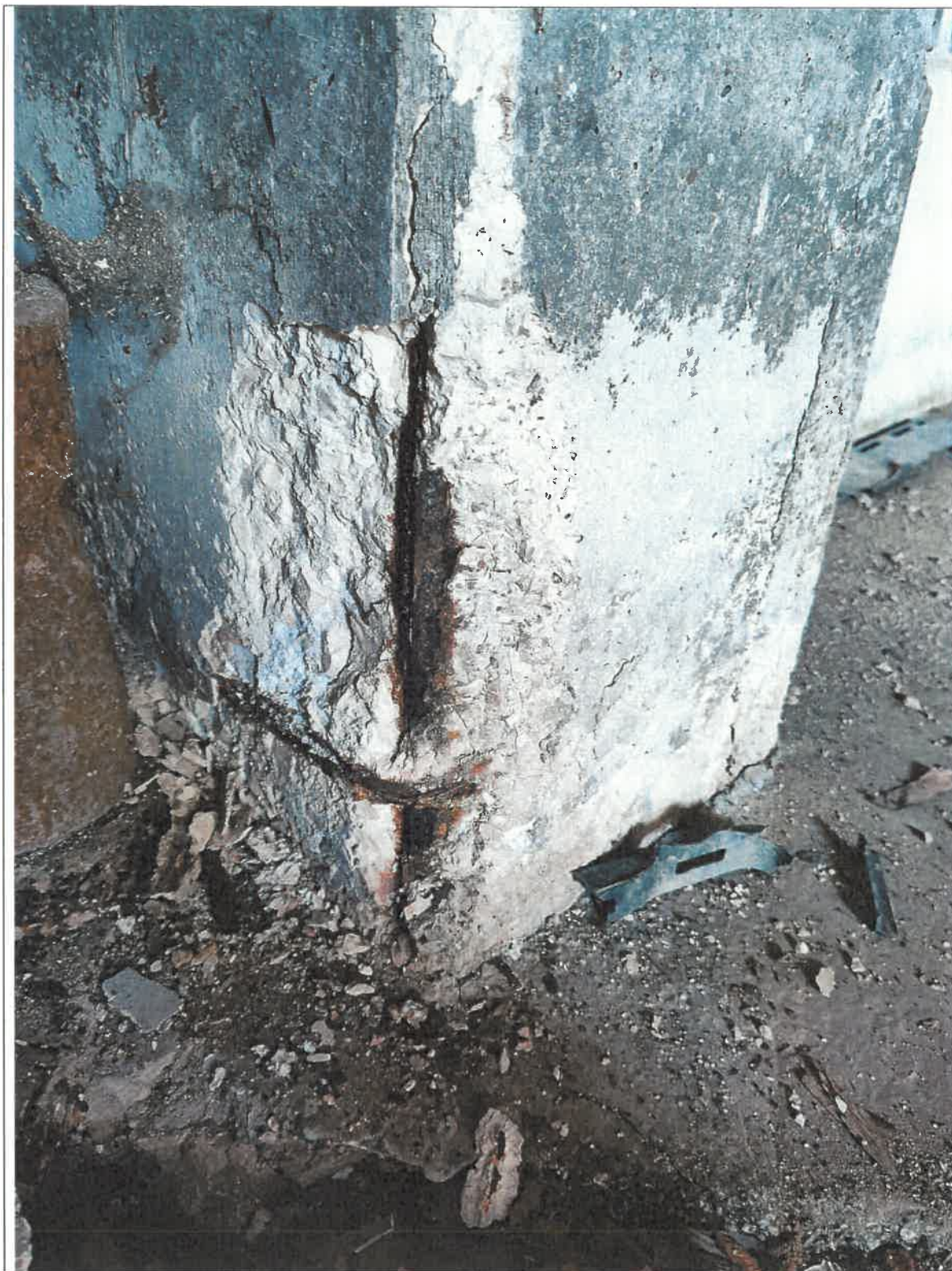
(sl. br. 24 – prikaz uznapredovale korozije armature na donjem dijelu glavnog AB montažnog stupa građevine)
