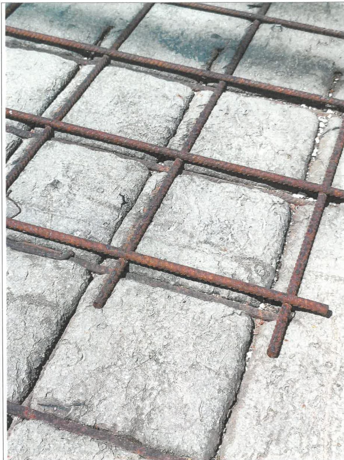
(sl. br. 31 – prikaz oštećenja podne ploče, armaturne mreže utisnute su u asfaltnu završnu oblogu komore)
