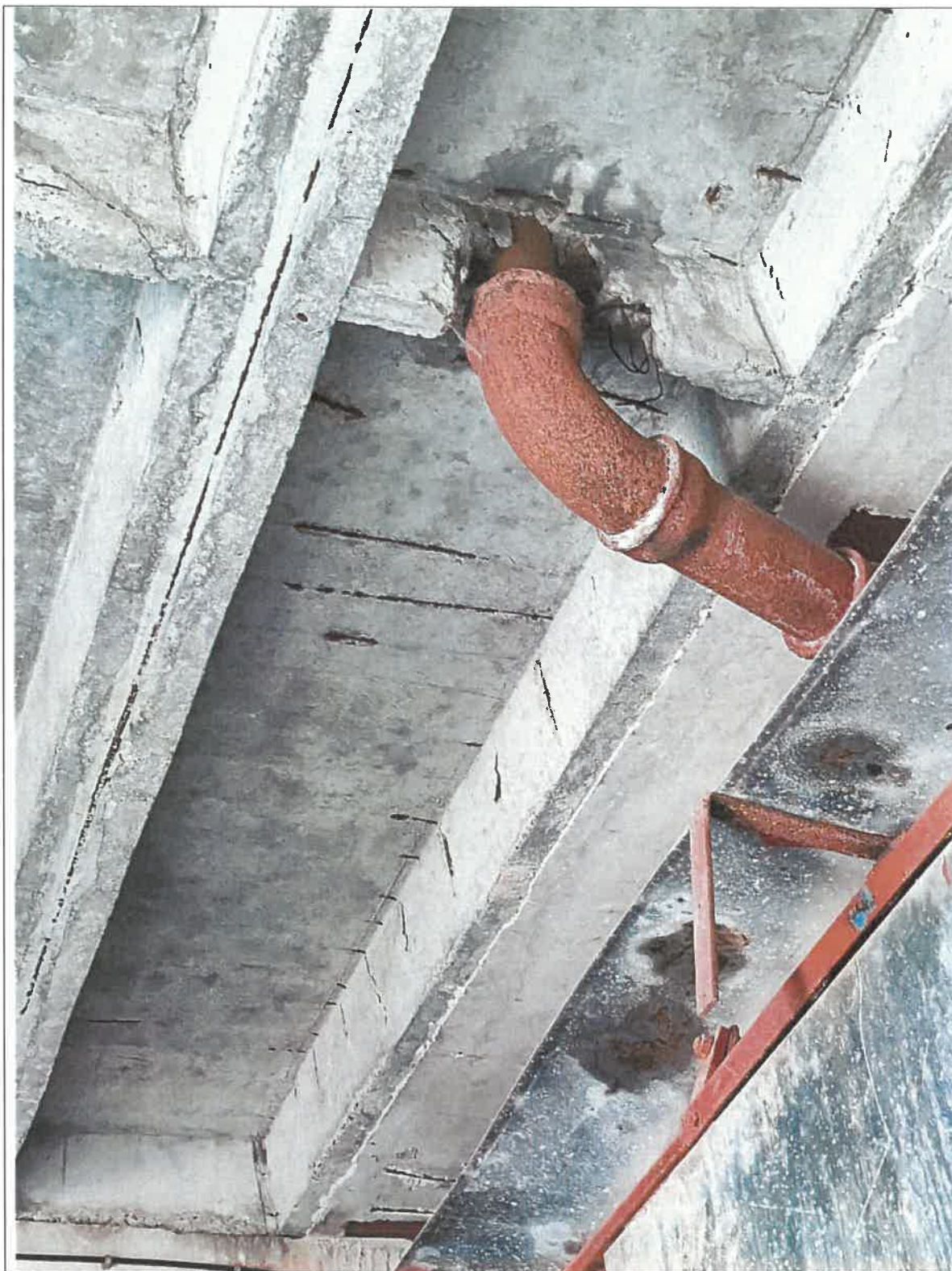
(sl. br. 28 – prikaz korozije armature donje zone u montažnim AB pločama iznad centralnog manipulativnog hodnika; vidljivo je da do korozije dolazi zbog nedostatne debljine zaštitnog sloja betona)
