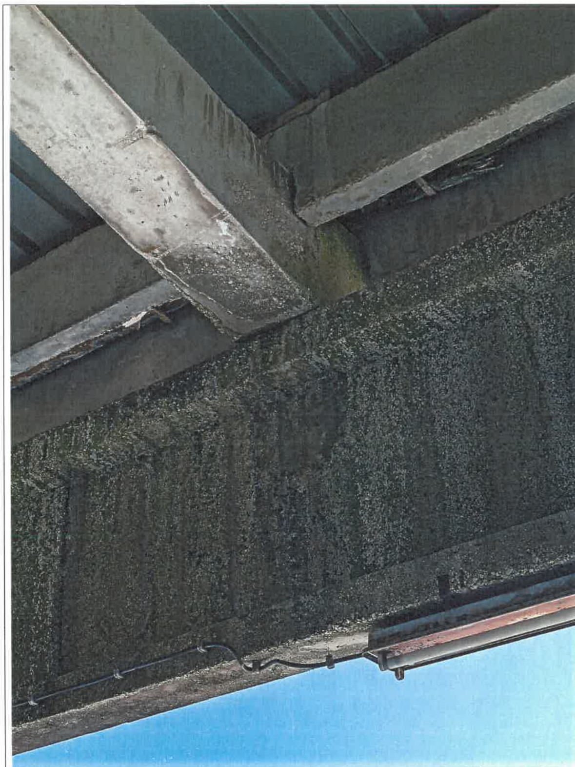
(sl. br. 6 – prikaz površinskog oštećenja prednapete montažne grede „I“ poprečnog presjeka koja je dio konstrukcije nadstrešnice istočne fasade; vidljivi su tragovi aktivnog curenja oborinske vode te lokalna eksfolijacija betona)
