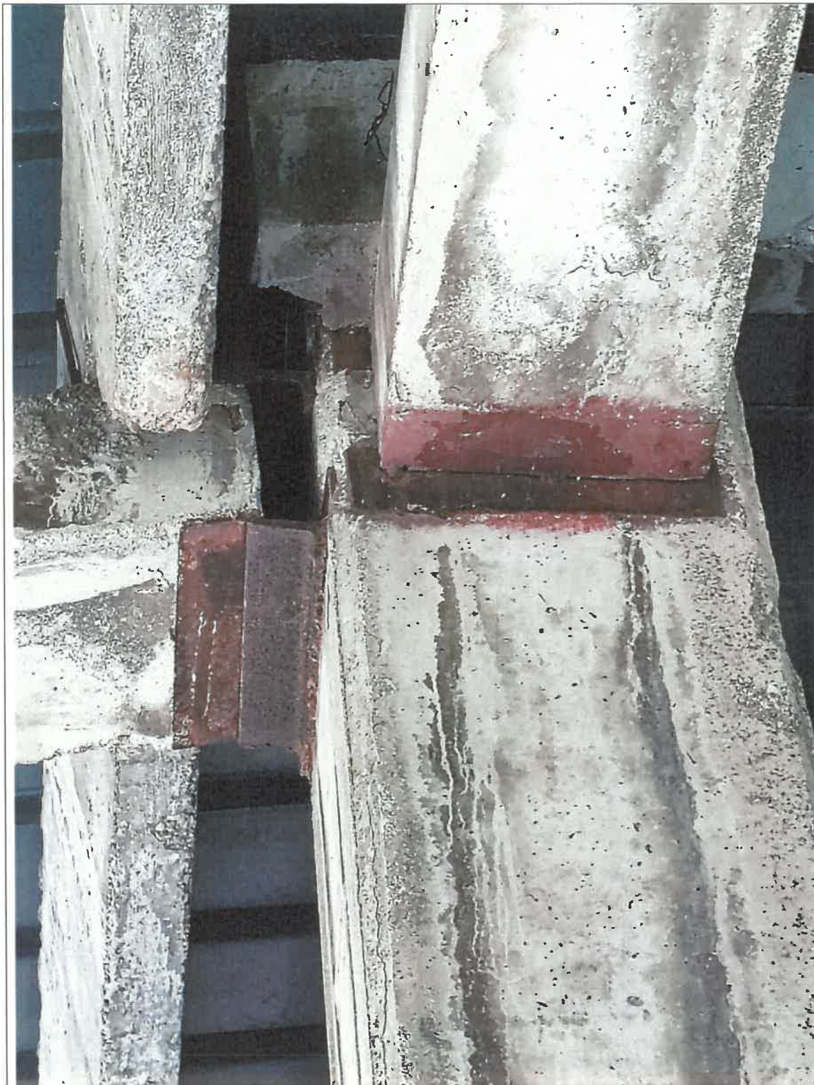
(sl. br. 14 – prikaz nestručno izvedenog spoja glavnog AB montažnog stupa hale s AB montažnom gredom nadstrešnice koja je „V“ oblika; nadstrešnica istočne fasade građevine; vidljiv je značajan ekscentricitet u spoju i prisustvo korozije čeličnih spojnih elemenata )
