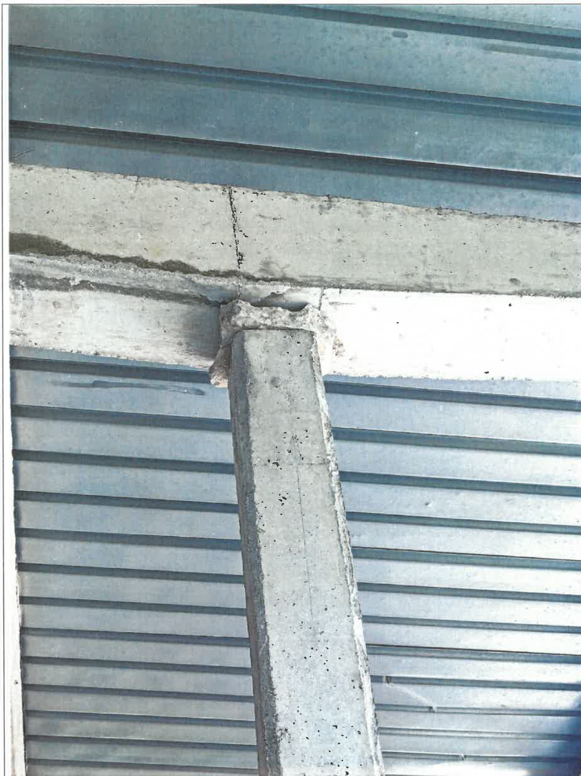
(sl. br. 10 – prikaz nestručno izvedenog spoja AB montažnog stupa i AB montažne grede „V“ oblika; nadstrešnica sjeverne fasade građevine)
