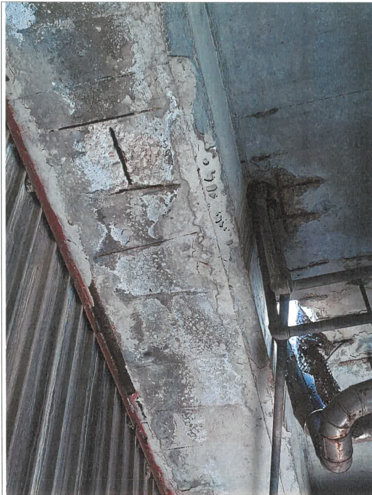
(sl. br. 26 – prikaz korozije vilica/spona na gredi „H“ centralnih stupova; manipulativni hodnik; vidljivo je da do korozije dolazi zbog nedostatne debljine zaštitnog sloja betona)
