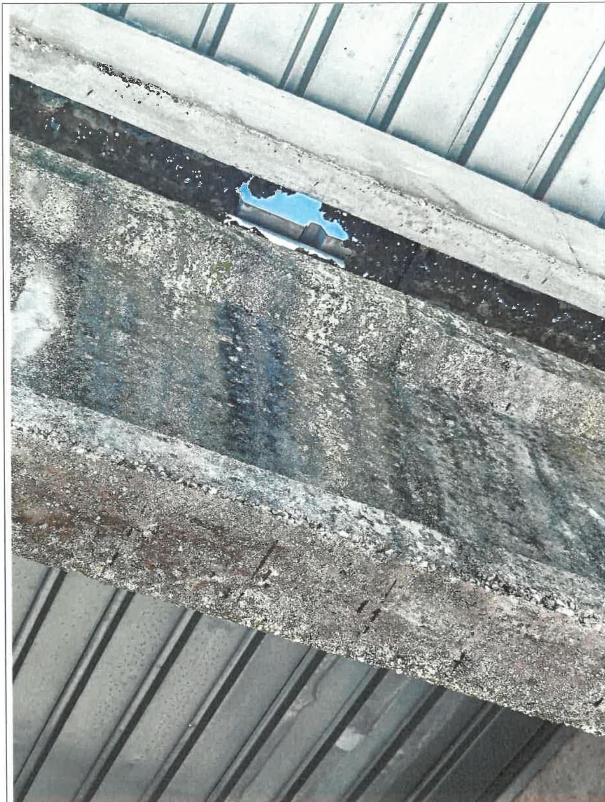
(sl. br. 7 – prikaz površinskog oštećenja prednapete montažne grede „I“ poprečnog presjeka koja je dio konstrukcije nadstrešnice istočne fasade; vidljivi su tragovi aktivnog curenja oborinske vode, lokalna eksfolijacija betona kao i korodirane vilice/spone u donjoj zoni grede zbog nedovoljno zaštitnog sloja betona)
