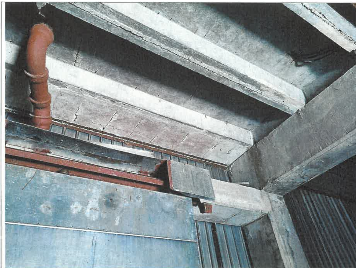
(sl. br. 30 – prikaz korozije armature donje zone u montažnim AB pločama iznad centralnog manipulativnog hodnika; vidljivo je da do korozije dolazi zbog nedostatne debljine zaštitnog sloja betona)
