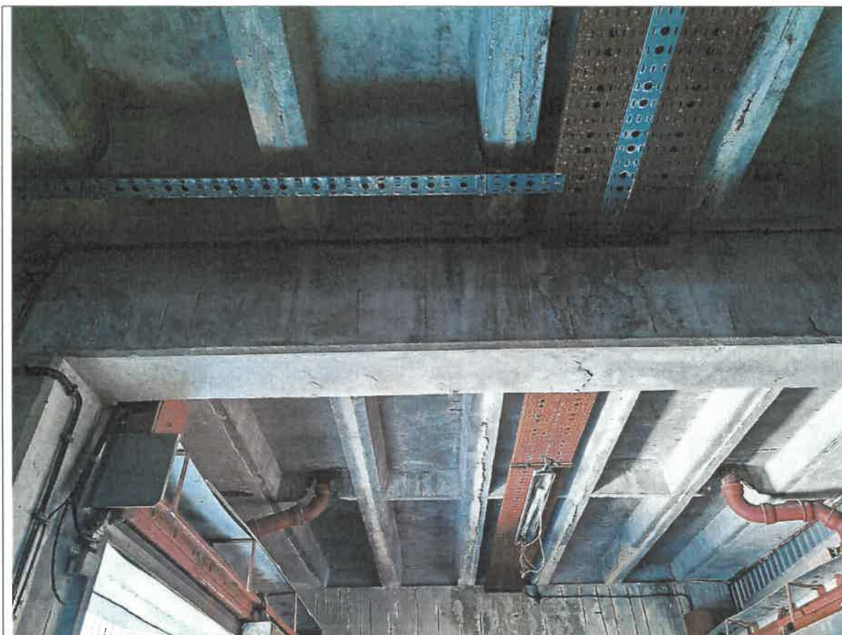
(sl. br. 19 – prikaz korozije vilica/spona na gredi „H“ centralnih stupova; manipulativni hodnik; vidljivo je da do korozije dolazi zbog nedostatne debljine zaštitnog sloja betona)
