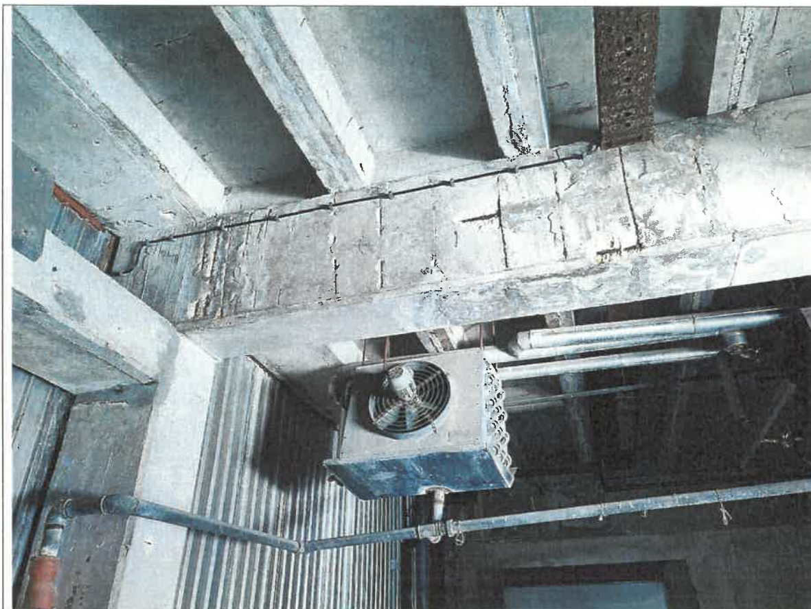
(sl. br. 22 – prikaz korozije vilica/spona na gredi „H“ centralnih stupova; manipulativni hodnik; vidljivo je da do korozije dolazi zbog nedostatne debljine zaštitnog sloja betona)
