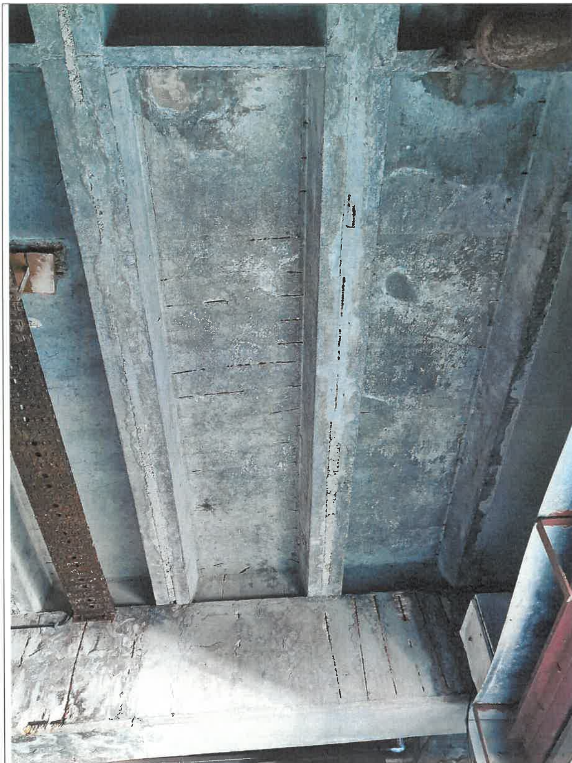
(sl. br. 29 – prikaz korozije armature donje zone u montažnim AB pločama iznad centralnog manipulativnog hodnika; vidljivo je da do korozije dolazi zbog nedostatne debljine zaštitnog sloja betona)
