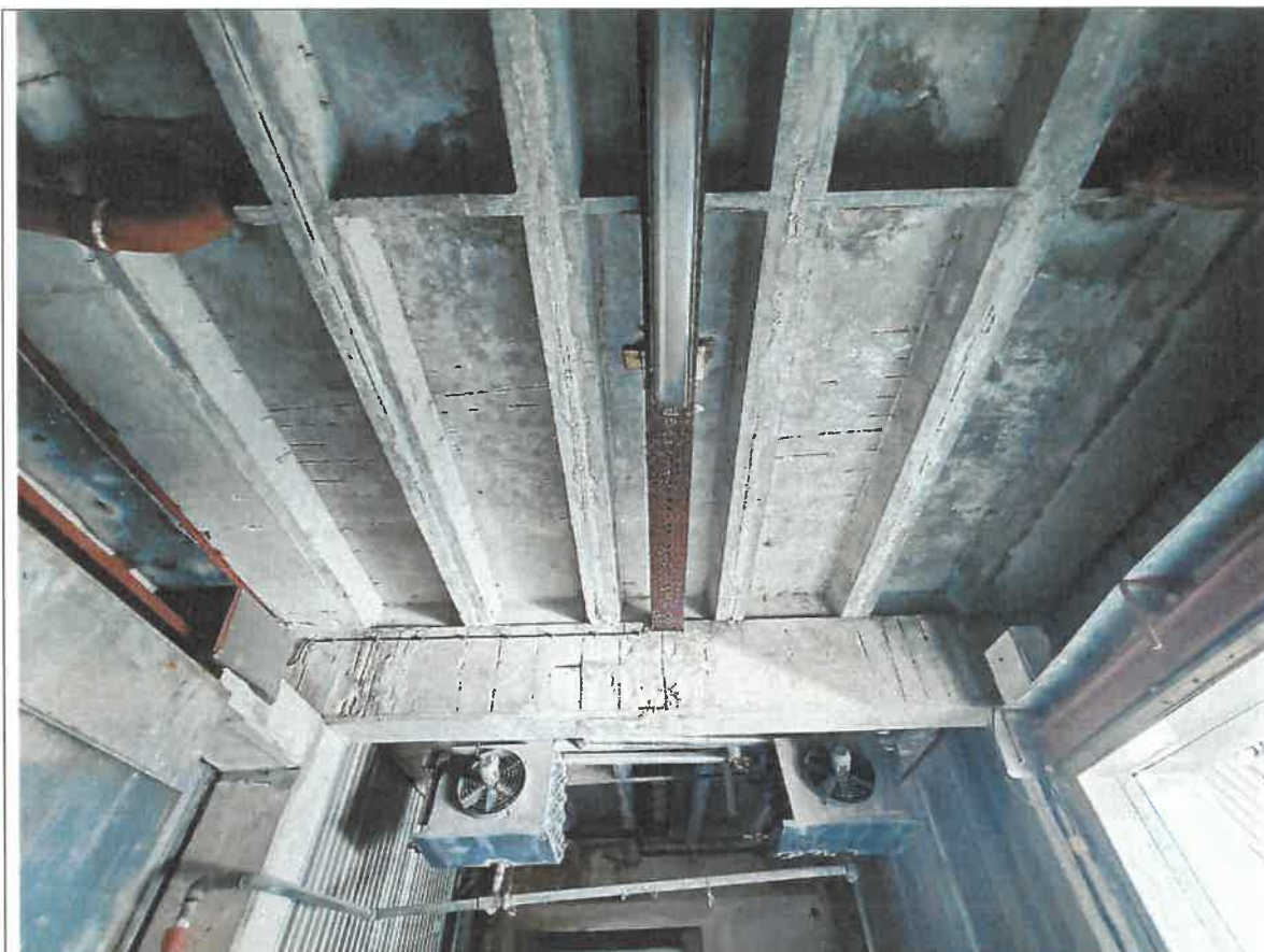
(sl. br. 27 – prikaz korozije armature donje zone u montažnim AB pločama iznad centralnog manipulativnog hodnika; vidljivo je da do korozije dolazi zbog nedostatne debljine zaštitnog sloja betona)
