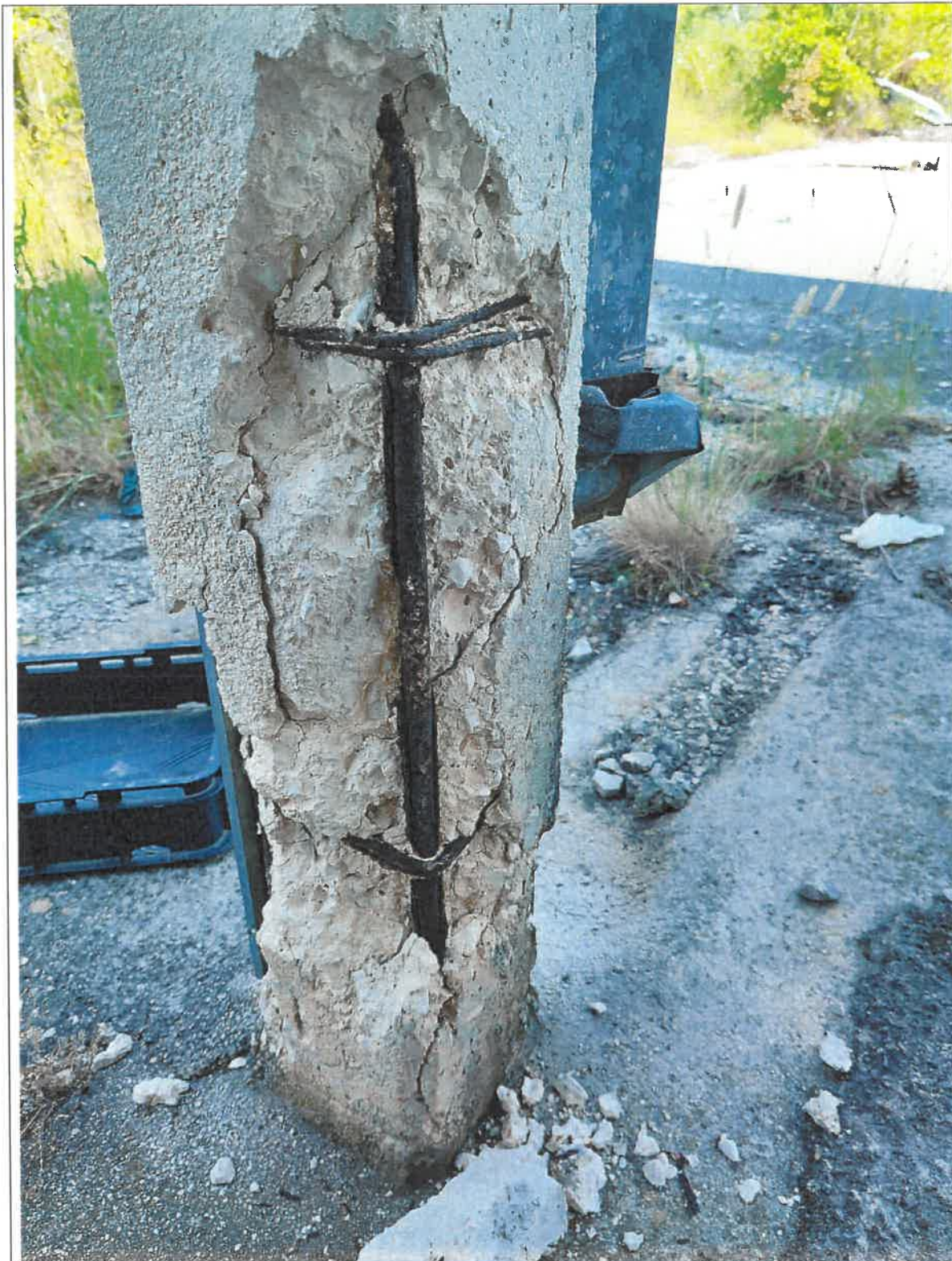
(sl. br. 11 – prikaz uznapredovale korozije armature na donjem dijelu stupa nadstrešnice sjeverne fasade; zbog korozije armature došlo je do otpadanja zaštitnog sloja betona a što je dovelo do smanjenja poprečnog presjeka stupa)
