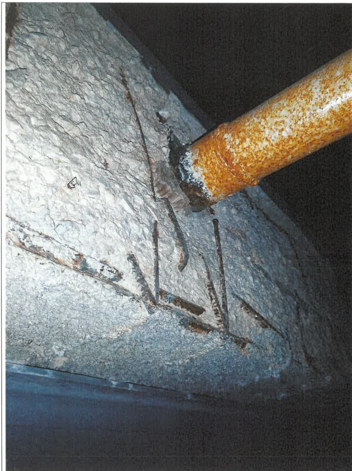
(sl. br. 34 – prikaz uznapredovale korozije armature te površinske degradacije i erozije betonske površine na AB gredi komore/tunela za smrzavanje; oštećenja su očekivana s obzirom na ekstremne uvjete koji vladaju u tunelima za smrzavanje, odnosno vrlo niske temperature u kombinaciji s velikim brzinama strujanja zraka)
