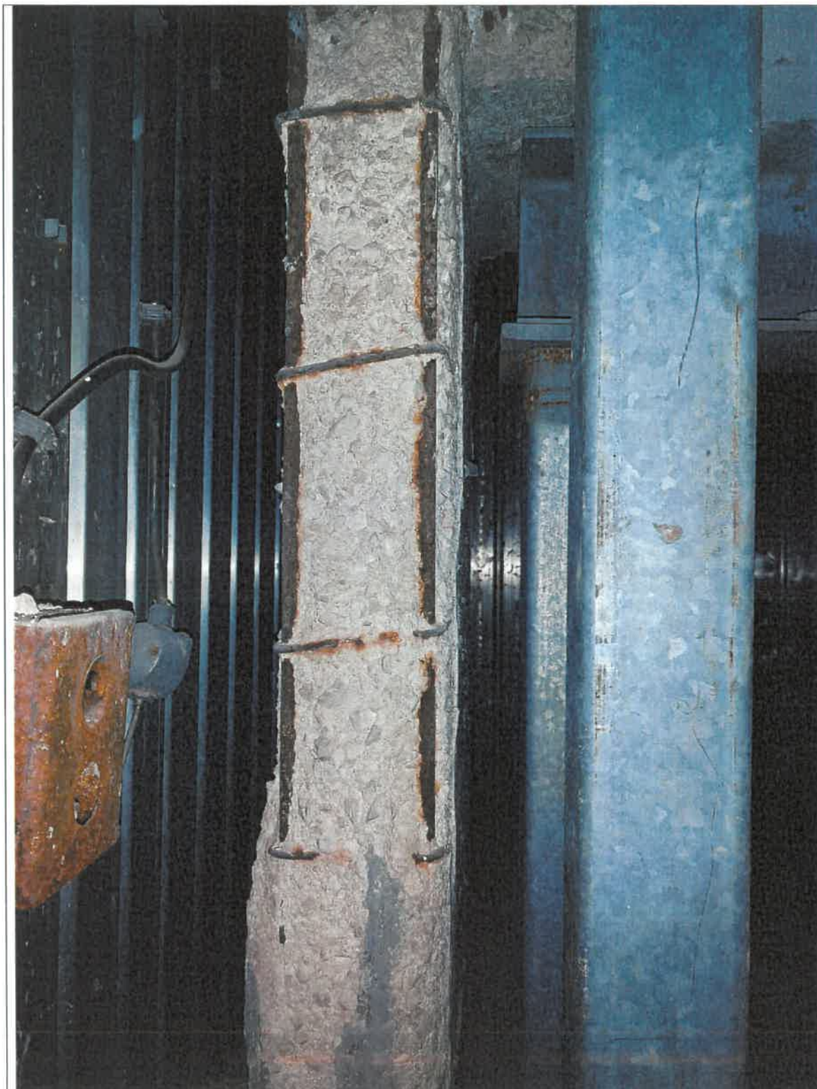
(sl. br. 32 – prikaz uznapredovale korozije armature te površinske degradacije i erozije betonske površine na AB zidu komore/tunela za smrzavanje; oštećenja su očekivana s obzirom na ekstremne uvjete koji vladaju u tunelima za smrzavanje, odnosno vrlo niske temperature u kombinaciji s velikim brzinama strujanja zraka)
