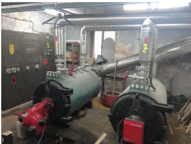
28. Kotlovi za grijanje vode
