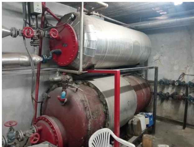
29. Bojleri vode u kotlovnici
