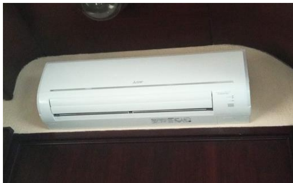
42. Klima uređaj Mitshubishi electric
