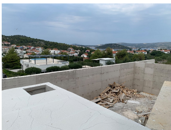
Krovnna terasa s nedovršenom AB konstrukcijom bazena, građevinski otpad
