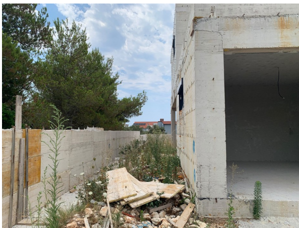
Bočno pročelje s otvorom garaže, vidljiva oksidacija armature
