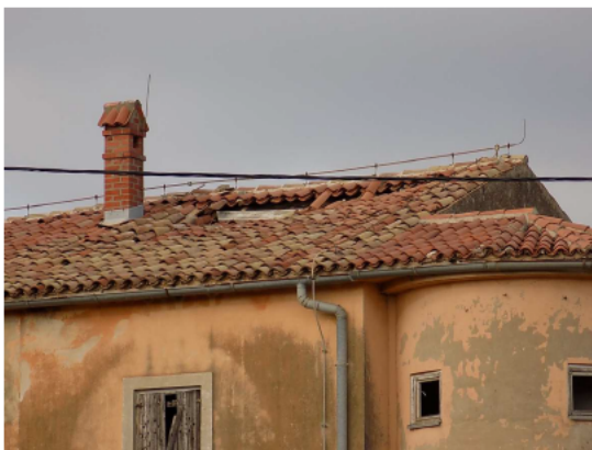
Vidljiva oštećenja i devastiranost
