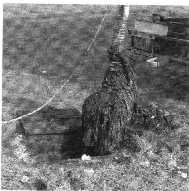
Vlažne maramice u kanalizacijskom kolektoru
