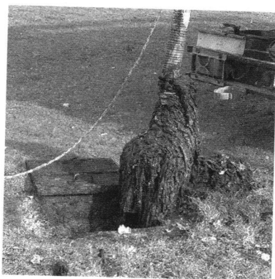
Vlažne maramice u kanalizacijskom kolektoru
