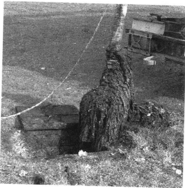
Vlažne maramice u kanalizacijskom kolektoru
