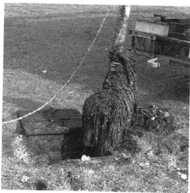
Vlažne maramice u kanalizacijskom kolektoru
