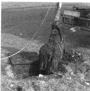
Vlažne maramice u kanalizacijskom kolektoru
