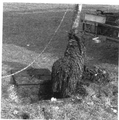
Vlažne maramice u kanalizacijskom kolektoru
