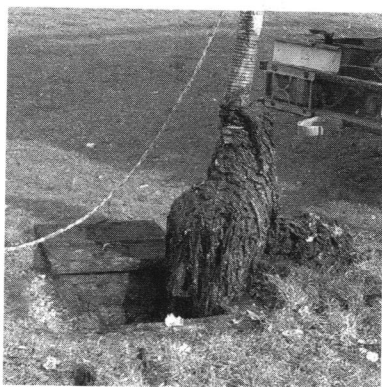
Vlažne maramice u kanalizacijskom kolektoru
