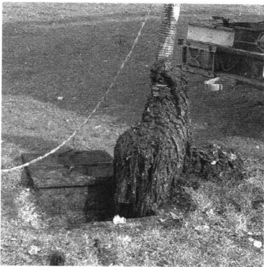
Vlažne maramice u kanalizacijskom kolektoru
