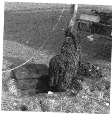
Vlažne maramice u kanalizacijskom kolektoru
