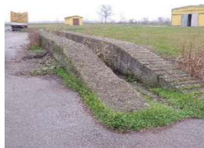
rampa za pranje vozila
