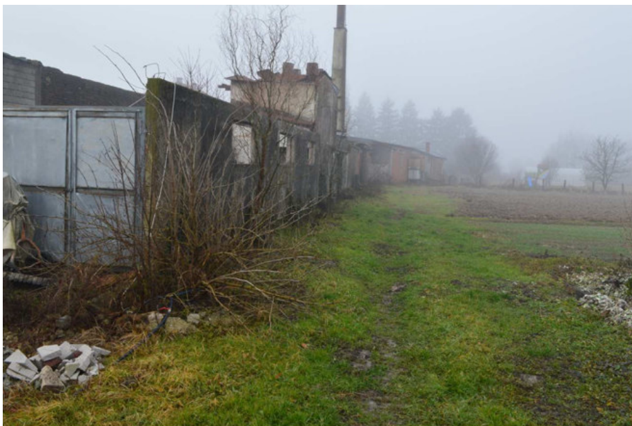
Pogled na trošnu zgradu Pilane na k.č.br. 52/6 ( sjeverno pročelje)
