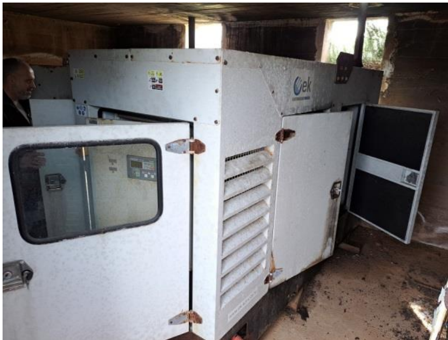
Sl.1 Agregat Iveco EO 80162- ZPQ100.AQ1B, 80kW
