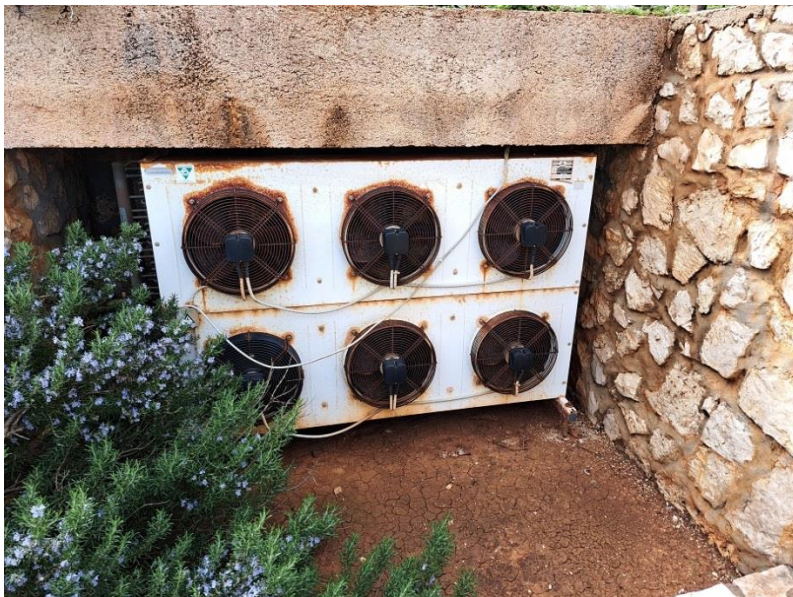
Sl. 9 Rashladni uređaj podruma i bačve, vanjska jedinica
