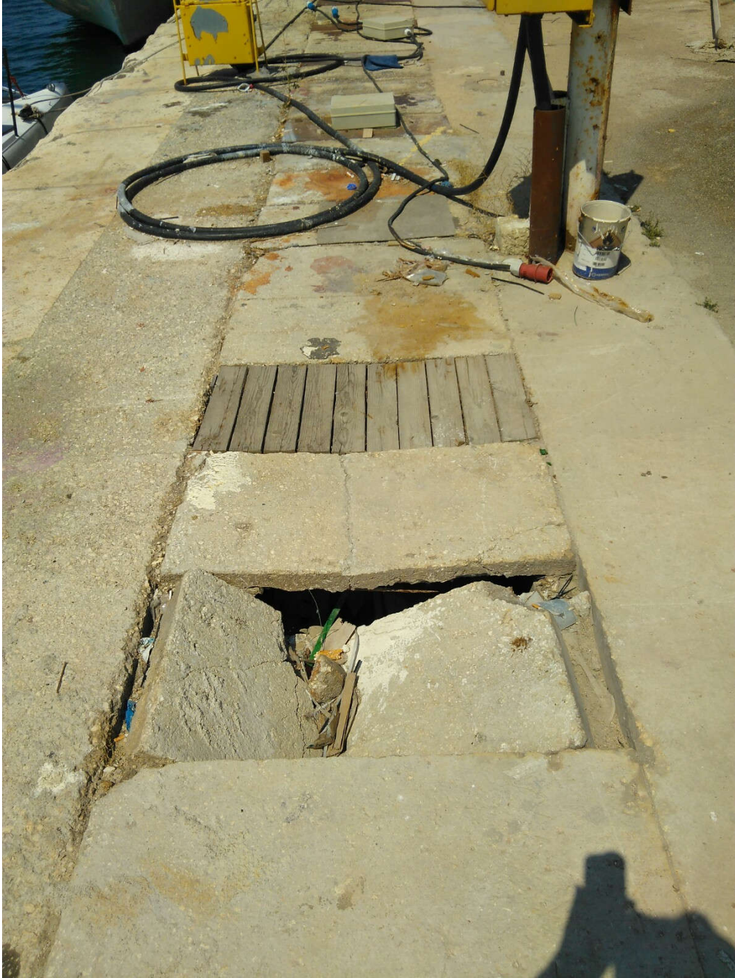
Slika 20. Razbijene poklopnice instalacijskog kanala
