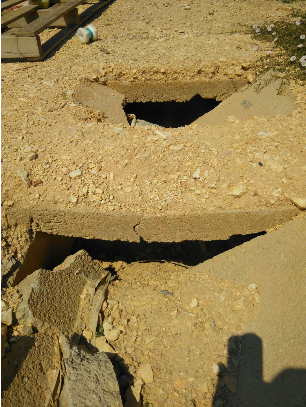
Slika 19. Razbijene poklopnice instalacijskog kanala
