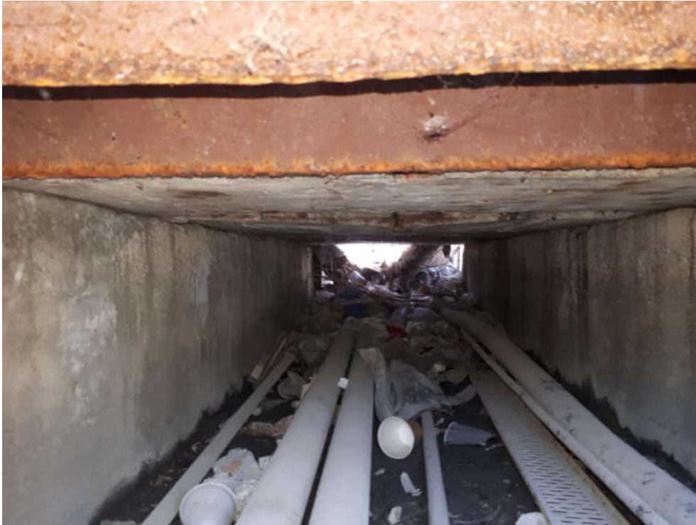
Slika 21. Instalacijski kanal izbutra zatrpan zemljom i pun smeća
