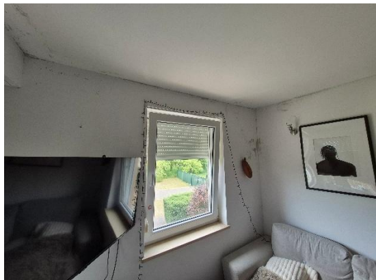
DNEVNI BORAVAK – TRAGOVI VLAGE I PUKOTINE
