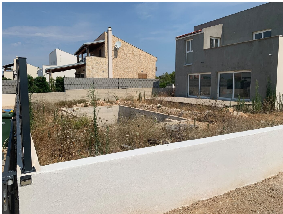
Fotografija 10 Armiranobetonska konstrukcija bazena, bez hidroizolacije i obloge
