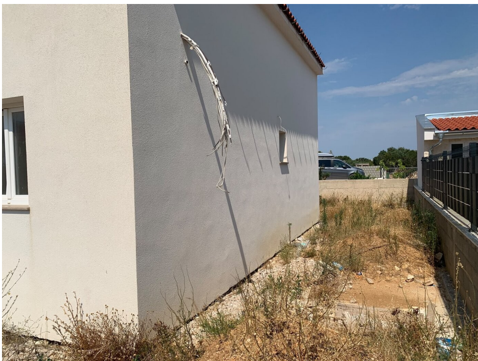
Fotografija 4 Nezavršena el. instalacija na fasadi
