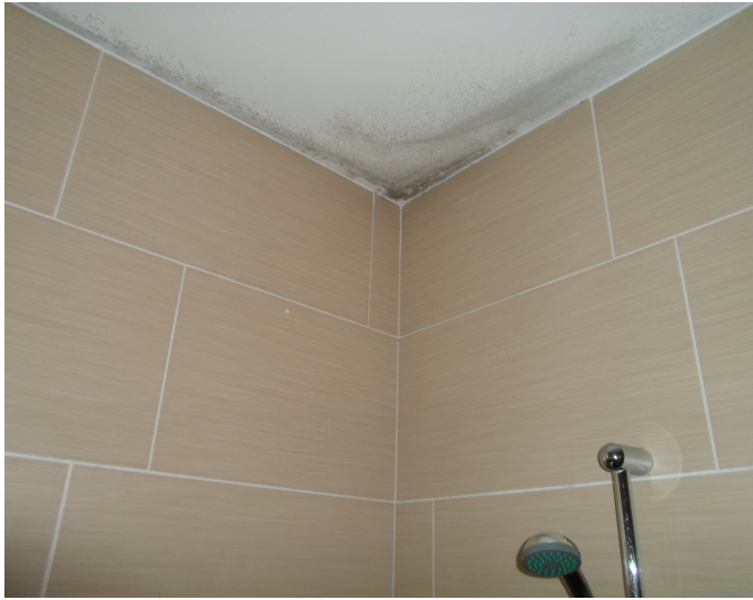
Foto 13: Unutrašnjost stana M8 – potkrovlje – kupaonica i WC – vidljivi tragovi vlage na stropu (15.06.20. 17.00 h)
