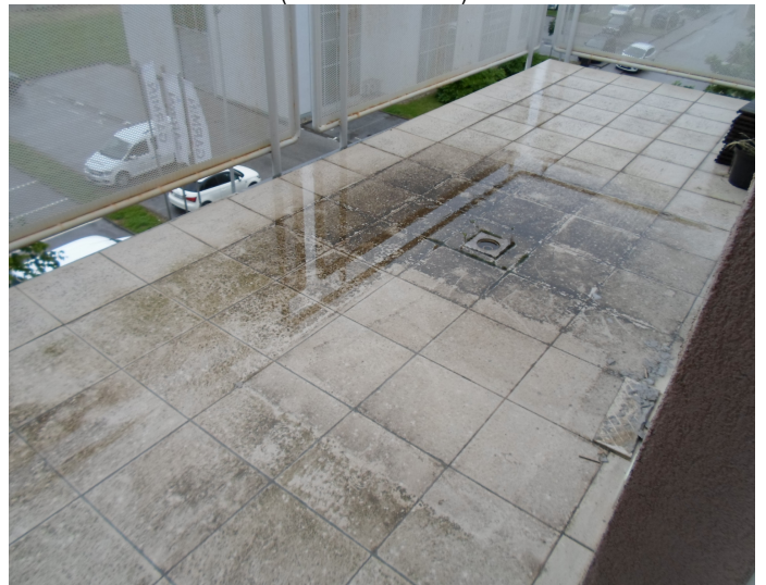
Foto 10: Unutrašnjost stana M8 – potkrovlje – terasa 1 – vidljivo stajanje vode na terasi (15.06.20. 17.00 h)
