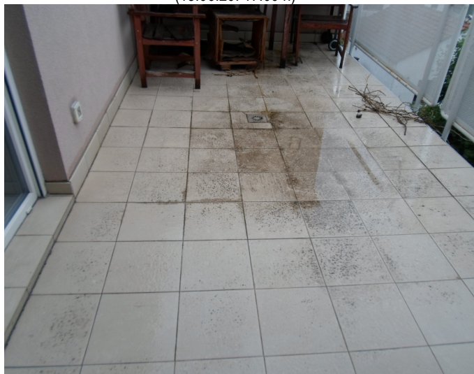
Foto 11: Unutrašnjost stana M8 – potkrovlje – terasa 2 – vidljivo stajanje vode na terasi (15.06.20. 17.00 h)
