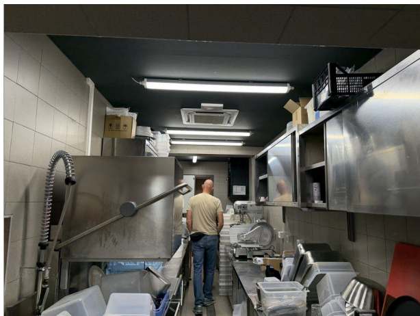
Foto 14. Kuhinja – keramika, strop, instalacije
