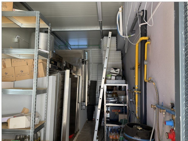
Foto 17. Skladište – plinska i vodovodna instalacija
