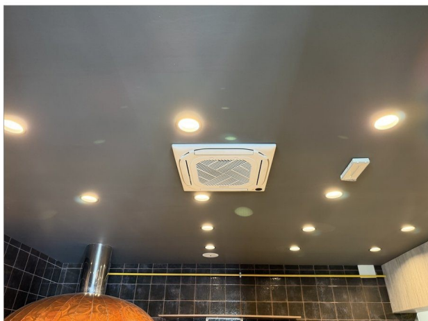
Foto 11. Spušteni strop – kazetna klima jedinica i rasvjeta
