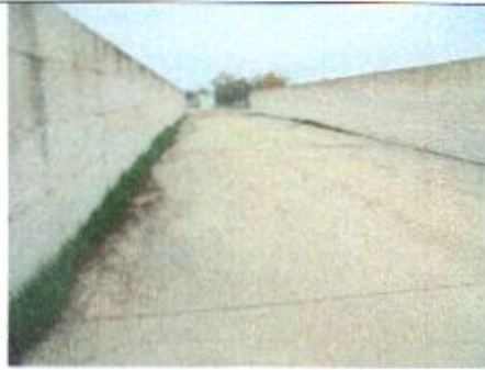
SLIKA 25 K.Č. 2351 TRENČ SILOS
