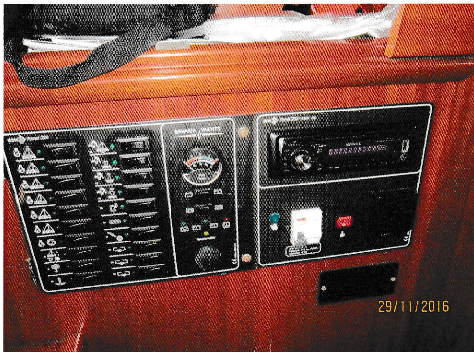
Slika 3: Razvodna ploča i radio
