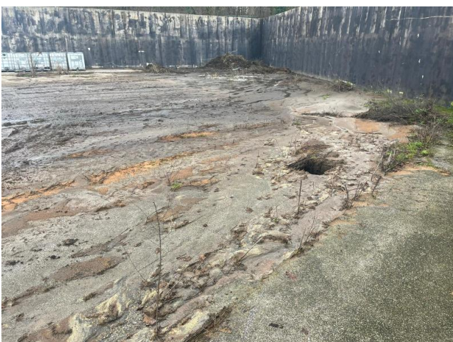
Fotografija 13. Oštećenje asfaltne podloge uslijed
