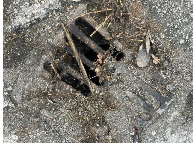
Fotografija 10. Začepljenost vanjske odvodnje
