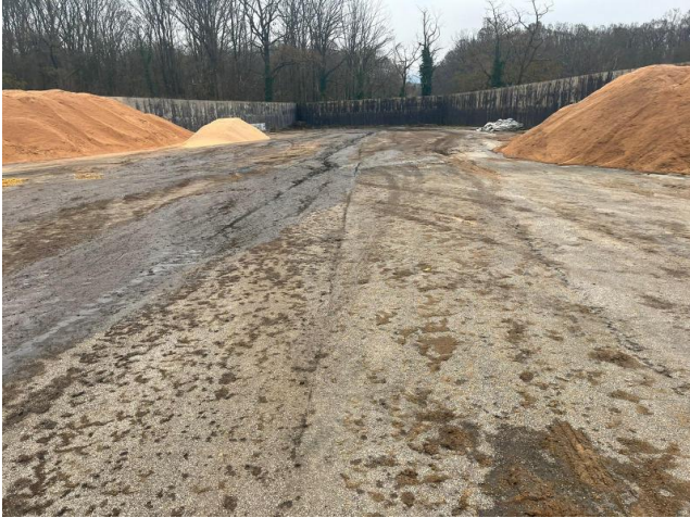
Fotografija 9. Puknuće asfaltnog sloja na južnoj laguni
