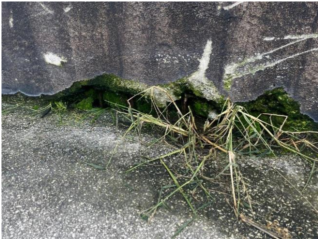
Fotografija 15. Oštećenja zapadnog zida sjeverne lagune
