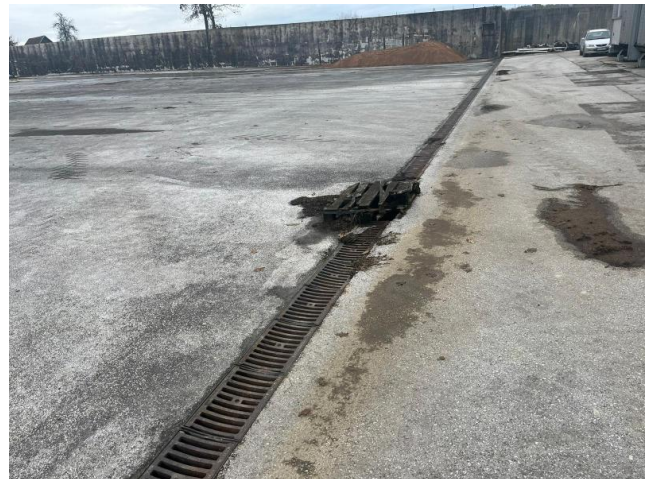
Fotografija 18 Oštećenje rigola i oštećenje šahta sjeverne piste
