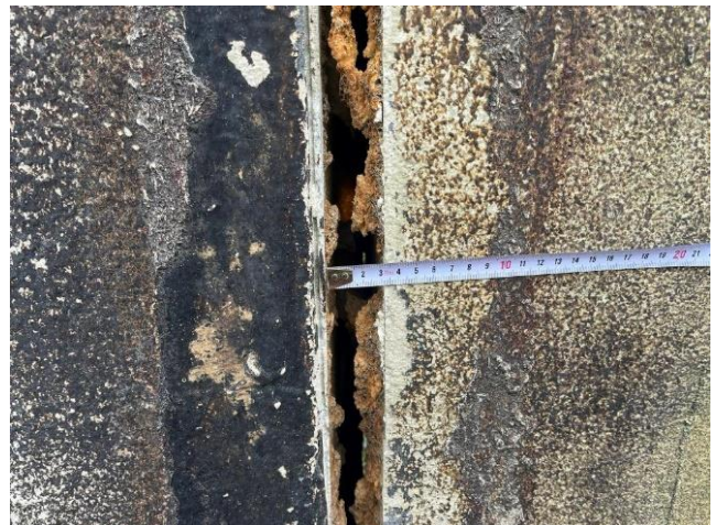
Fotografija 12. Odvajanja dijela zapadnog zida južne lagune (oko 3,0 cm)
