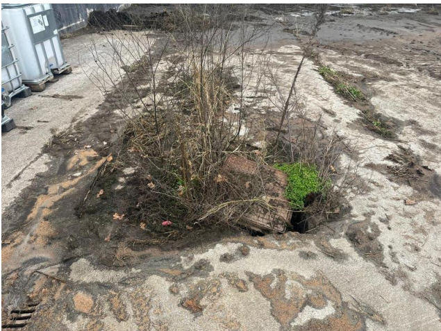
Fotografija 11. Začepljenost vanjske odvodnje
