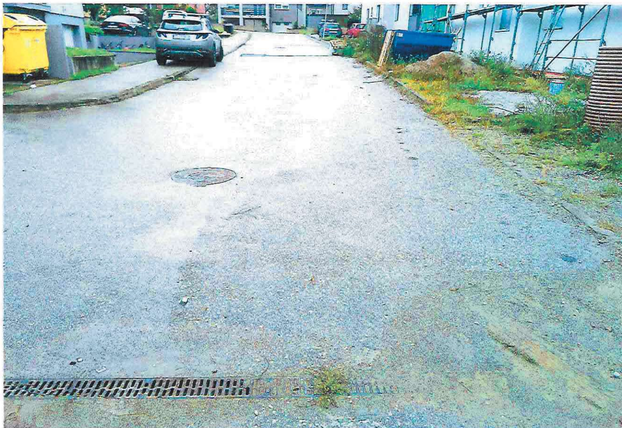
Slika 3 Pogled s juga čestice prema sjeveru (uzbrdo). Vidljiva je sabirna kanalica za oborinsku vodu s kolne površine. Upitna količina vodouponosti kod većih kiša.
