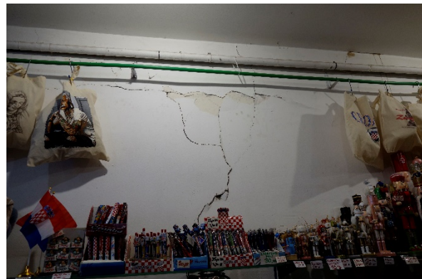
Slika 14: poslovni prostor zid prema veži
